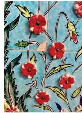
Fotoğraf: 31. Karo yüzeyinde hasar
